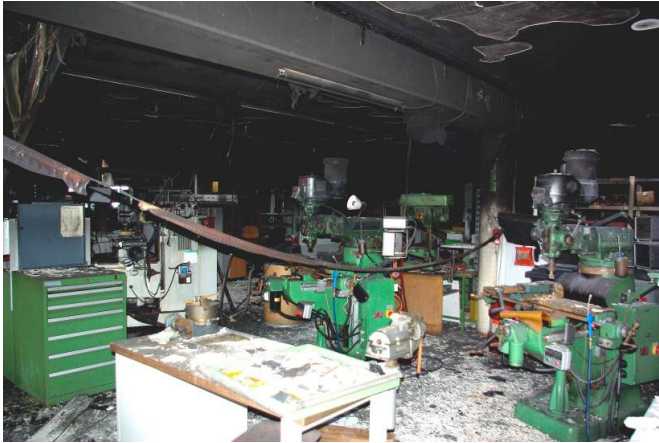
Abbildung 3: Brand eines Kunststoffverarbeitungsbetriebes im Jahr 2016: der Brandumfang beträgt nur ca. 5 m 2 - heiße Rauchgase verursachen jedoch auf ca. 1.000 m 2 einen Millionenschaden. Hier besteht enormes Potenzial zur Schadensreduzierung durch anlagentechnische Brandschutzmaßnahmen wie z.B. Rauch- und Wärmeabzugsanlage. (Quelle: Brandverhütungsstelle Niederösterreich mit freundlicher Genehmigung des Betreibers)
