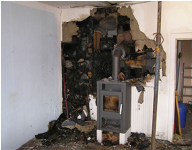
Abbildung 6: Ausgebautes Dachgeschoß mit Einzelfeuerstätte nach dem Brand 24
