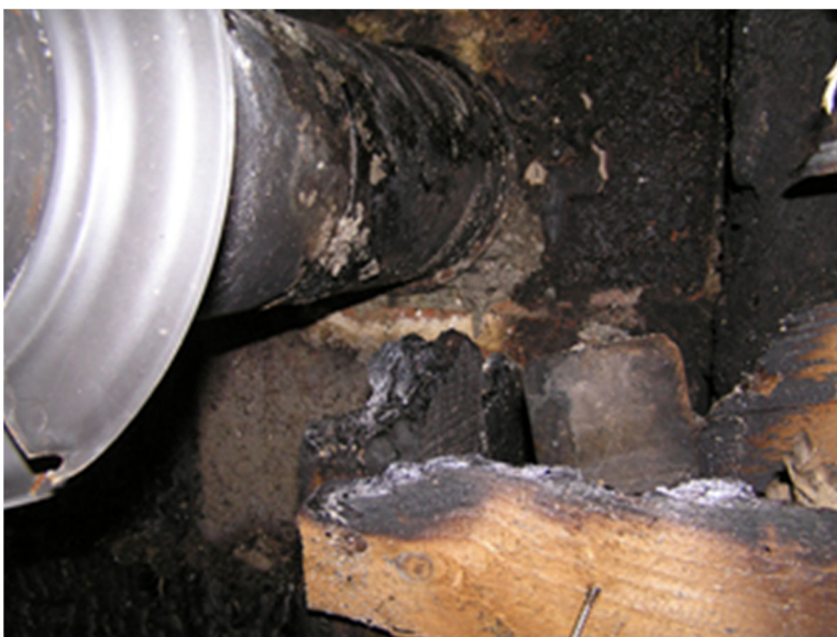
Abbildung 7: Rauchrohrbereich, in dem die Entzündung stattfand 26
